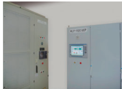
その他 原油移送ポンプ用 速度制御装置及び監視盤
