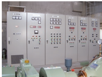
●排水機場向けポンプ制御盤
