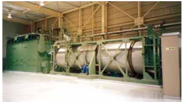
図16 予備発酵槽と本発酵槽
