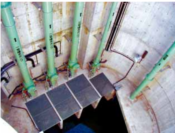
図4 ポンプ吸水槽(地上部より)
