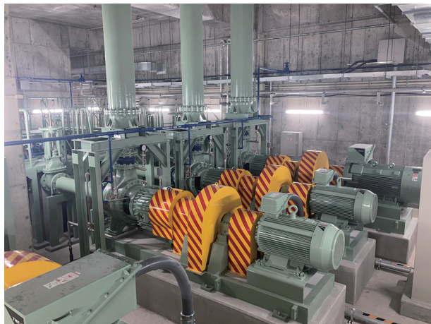
図4 汚水送水ポンプ室全景
