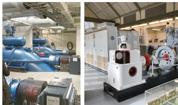
図2 オランダ・ドイツポンプ場内
