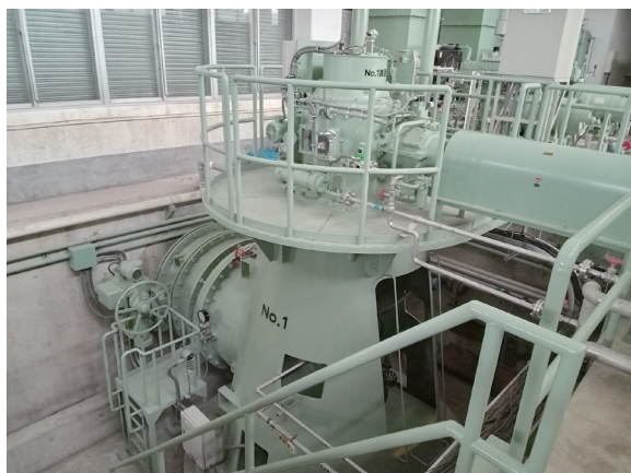
図2 ポンプ設備 (No.1主ポンプ)
