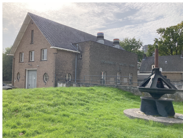
図1 オランダ・ドイツポンプ場全景
