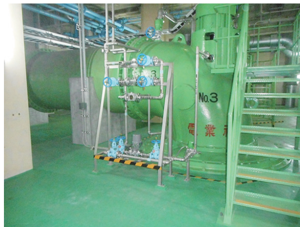
図5 雨水ポンプ設置状況
