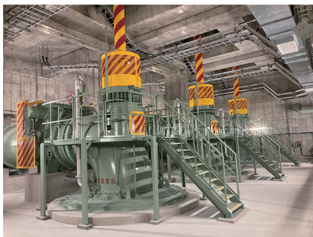
図3 雨水ポンプ室全景
