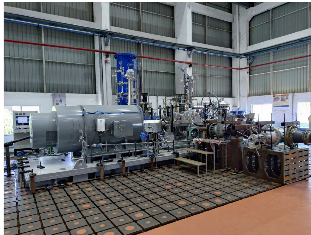
DMWインド社で初受注した大型多段高圧ポンプ
