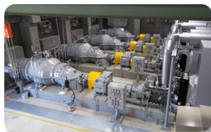
河川用雨水排水ポンプ
