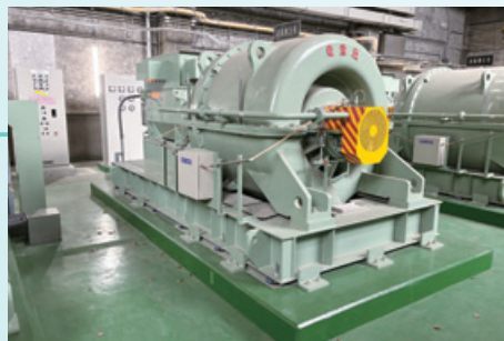
東京都下水道局殿向け (写真は森ヶ崎水再生センター)
