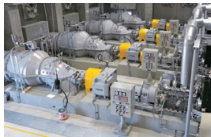
●排水機場向け排水ポンプ
