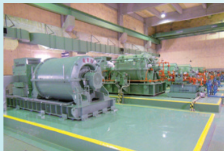
千葉県船橋市殿向け (写真は高瀬下水処理場)
