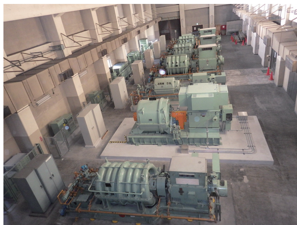
図4 送風機室全景
