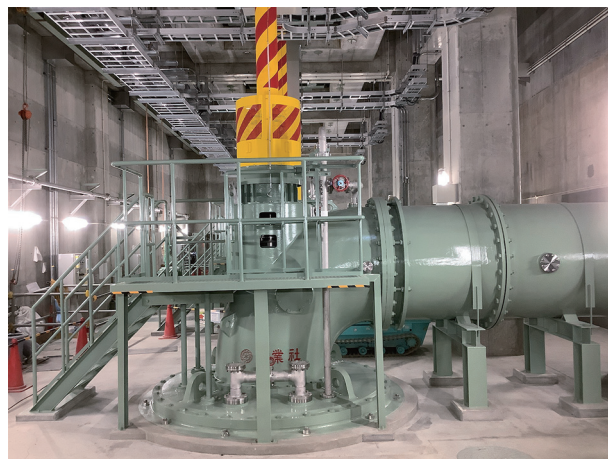
図3 雨水ポンプ全景
