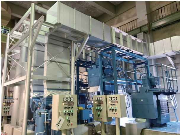
図6 No.3汚水ポンプエンジン外観 Fig.6 View of the No.3 engine unit
