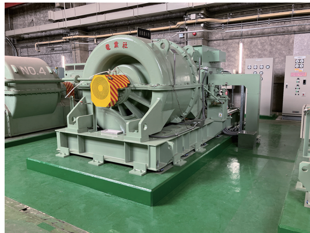
図5 送風機室全景
