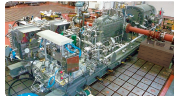
今回納入した原油圧送ポンプ
