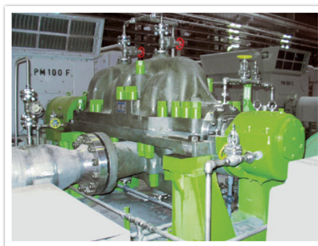
RO膜に海水を供給する高圧ポンプ
