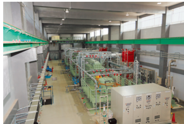
小名木川排水機場内ポンプ室
