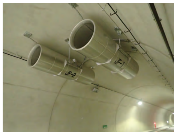
図2 鍋谷トンネル用ジェットファン Fig. 2 Jet Fans for Nabetani Tunnel
