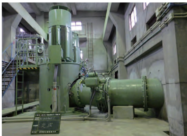
図5 1、2号合流雨水ポンプ
