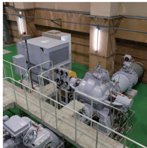
図5 送水ポンプ据付完成状況
