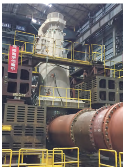
図4 循環水ポンプ外観
