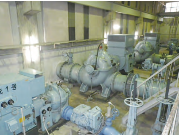
図2 既設設備写真
