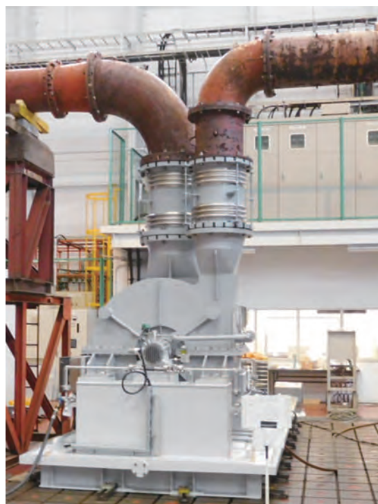
図6 工場試験 Fig.6 Factory acceptance test
