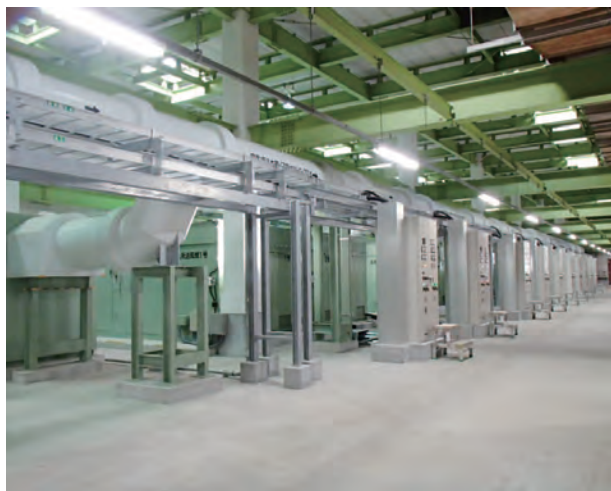
図8 新河岸水再生センター 送風機設備
