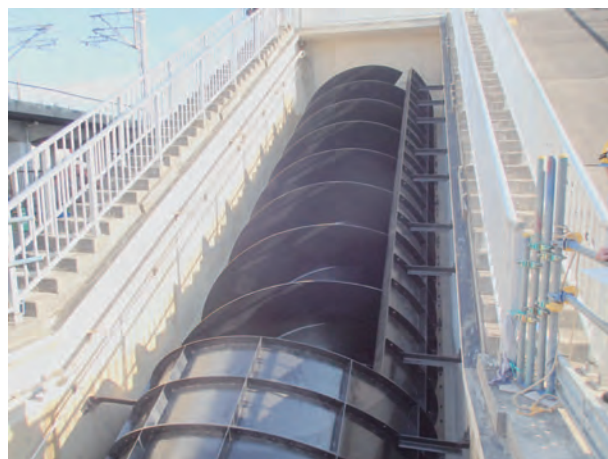
図7 スクリューポンプ全景
