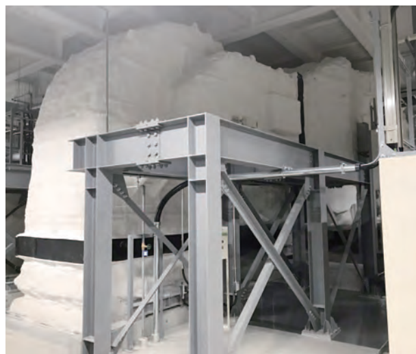
図10 主送風機 現地設置状況
