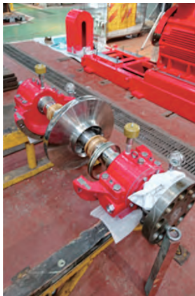
図3 消防検査御立会時写真 (写真提供：J-POWER [電源開発株式会社]) Fig.3 Witness Inspection (Photo credit：J-POWER)
