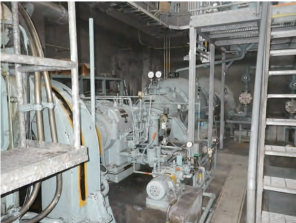
図1 既設ポンプ写真
