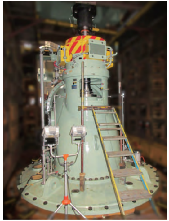
図2 吐出エルボ周りのセンサー設置状況
