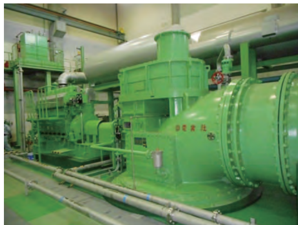
図2 雨水ポンプ設置状況
