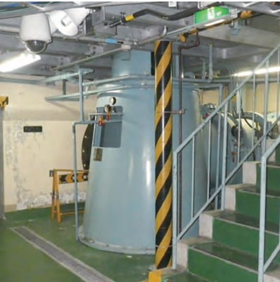
図1 既設ポンプ写真
