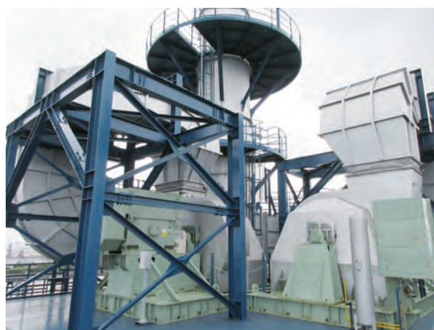
図8 分解炉ID FAN外観
