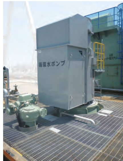
図4-1 循環水ポンプ
