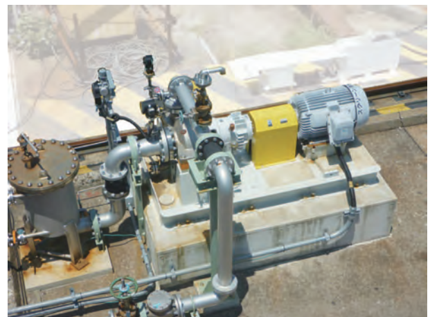
図4-2 スクリーン洗浄ポンプ
